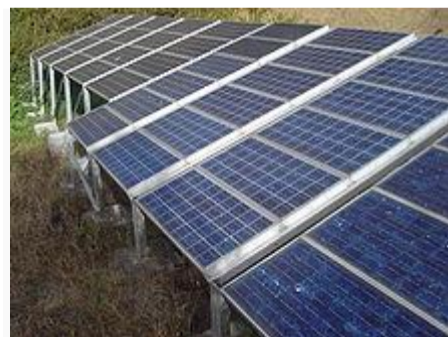
Batería de paneles solares.
